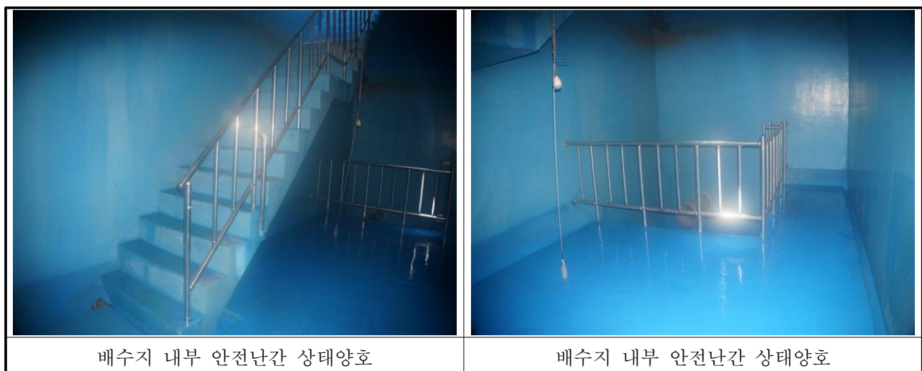
【사진 3.7】 안전시설(점검로) 손상사진
