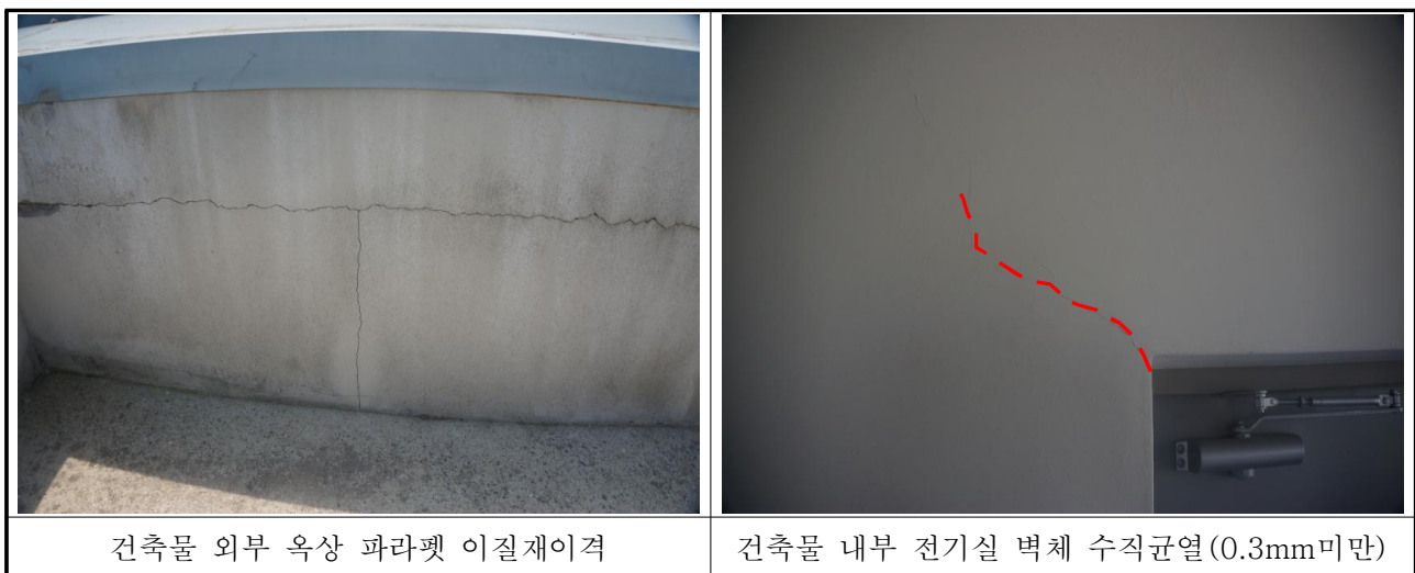
【사진 3.5】 건축구조물 손상사진
