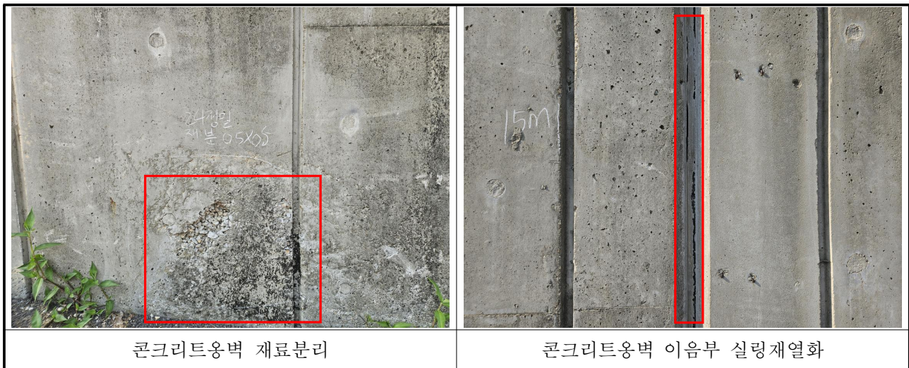
【사진 3.8】 기타 부대시설 손상사진(계속)
