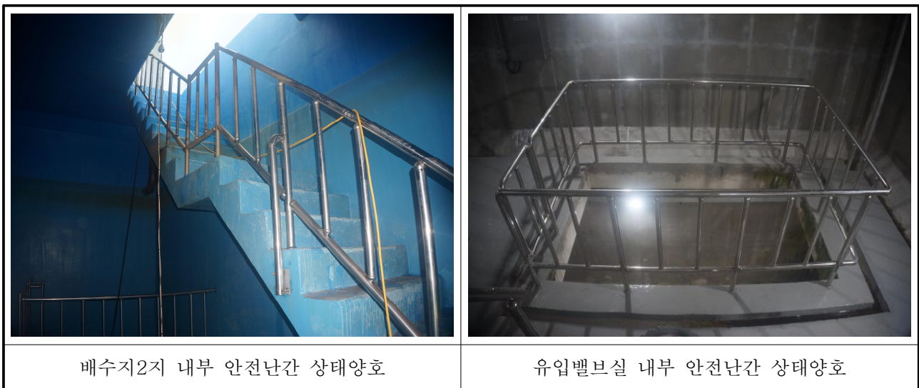
【사진 3.9】 추락방지시설 손상사진
